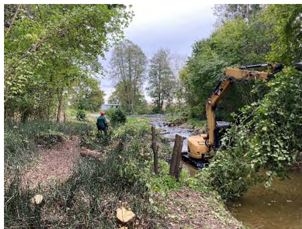
Abb. 2: zeigt die Gehölzarbeiten der Flussmeisterstelle Salzach als Voraussetzung für die Gewässeraufweitung und Verbesserung des Hochwasserschutzes.
